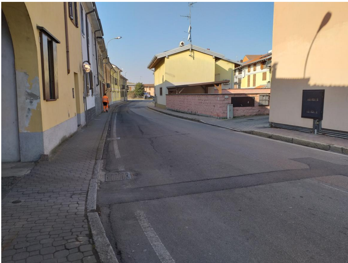
TRATTO C-D Via dei Mille - stato di fatto manto stradale
