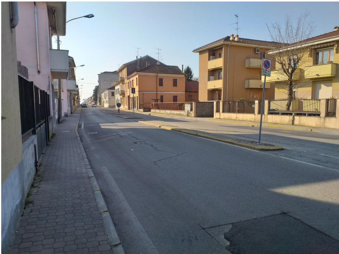
TRATTO A-B C.so Roma - stato di fatto manto stradale
